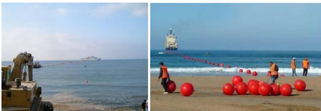
Figure 20 : Tirage du câble en flottaison par navire annexe et câble (à gauche) et câble en flottaison à l'aide
