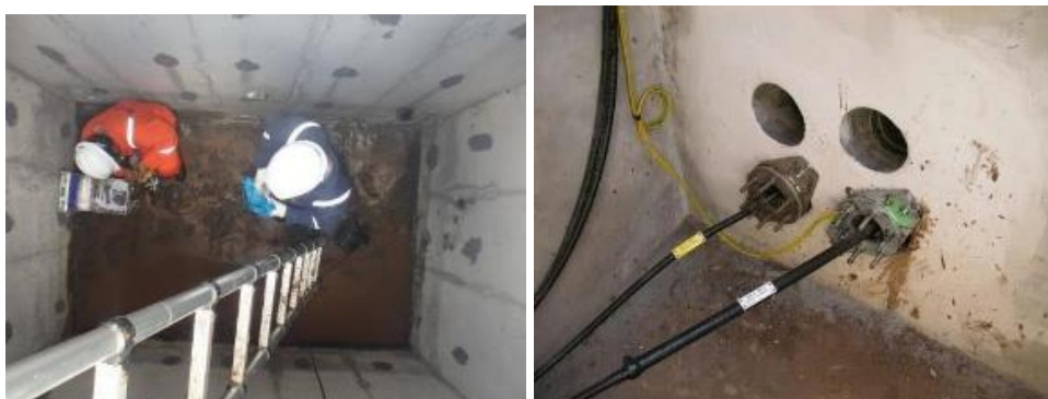
Figure 9 : Intérieur d'une chambre-plage et bride d'ancrage d'un câble
